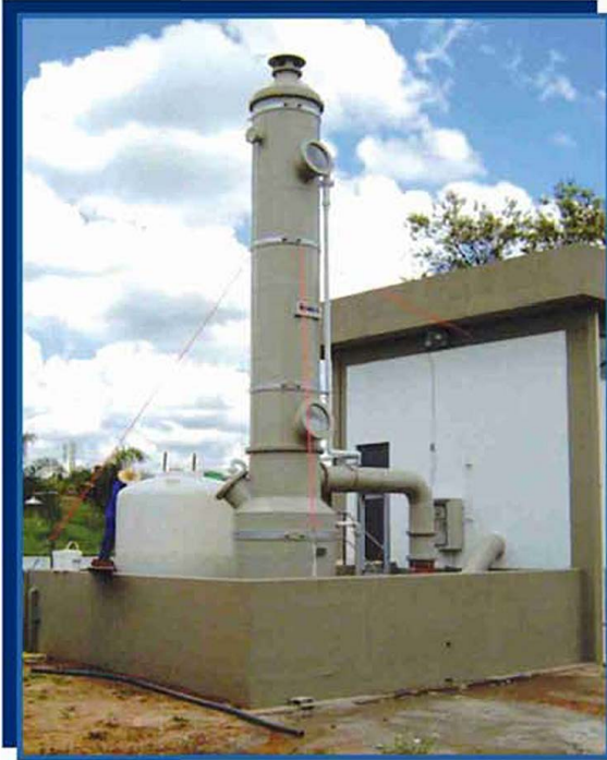
🔹 Lavador de Gases
