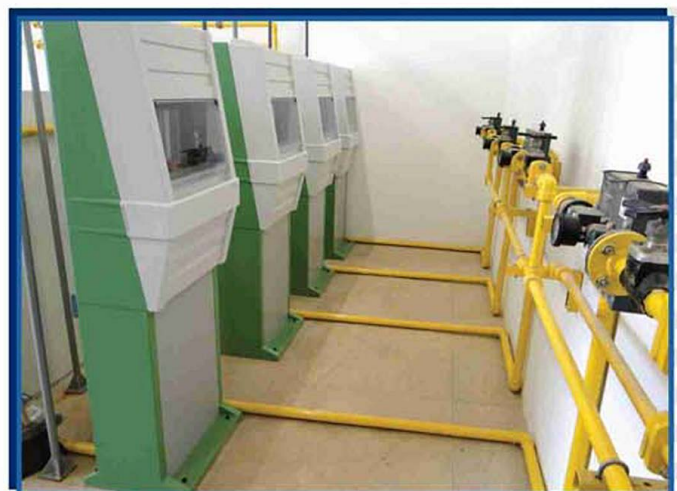
🔹 Sistema de Dosagem de Gás Cloro
